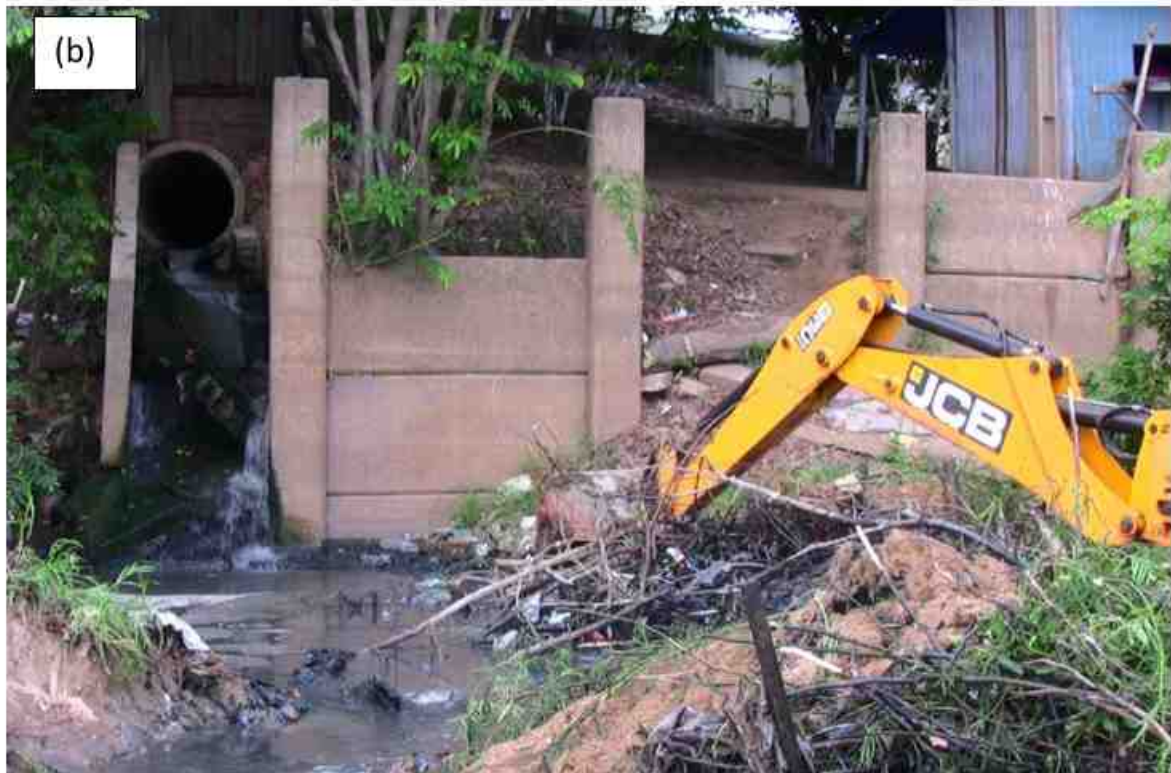
Figura 19 - (a) e (b) Áreas com despejo inadequado de esgoto. Fonte: Prefeitura de Imperatriz.
