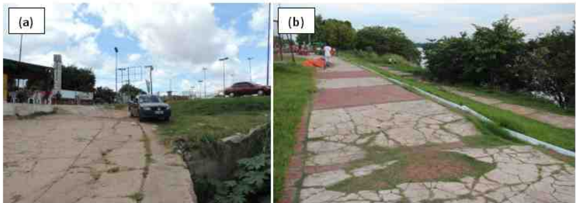
Figura 38 - (a) e (b) Calçadas com estado de conservação inadequado Fonte: Prefeitura de Imperatriz
